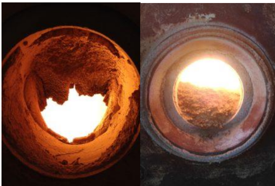
Fig 7 Slagging inside the boiler
