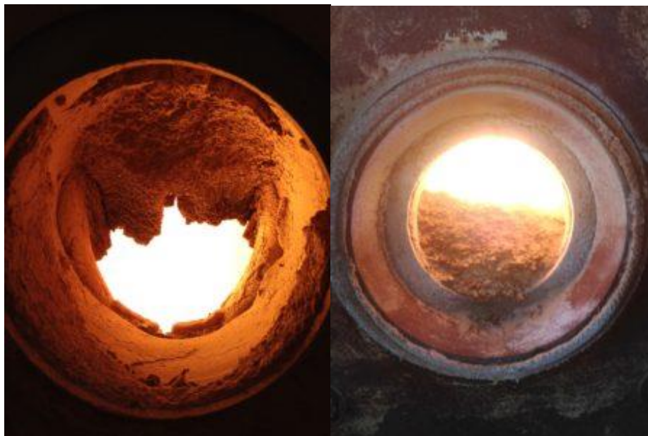
Fig 7 Slagging inside the boiler
